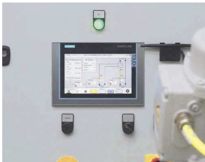
Mittlerweile hat Actemium die ersten Projekte mit der Process Device Library und SiVArc realisiert.
